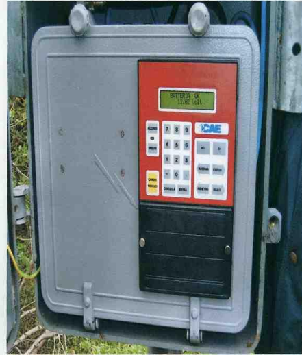
DETTAGLIO PANNELLO DI CONTROLLO
