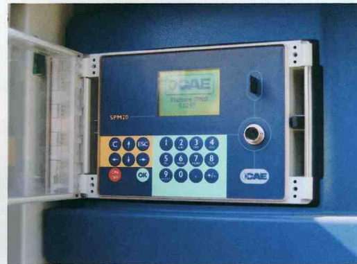
DETTAGLIO PANNELLO DI CONTROLLO
