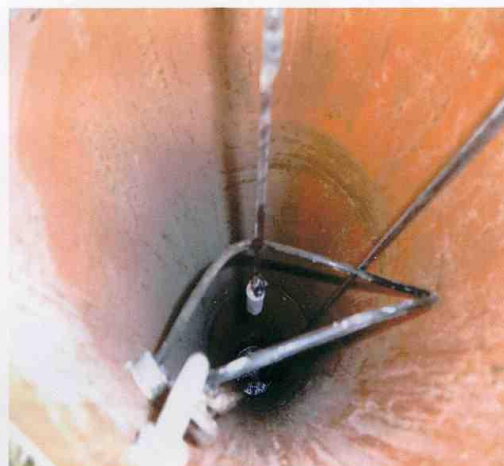
INTERNO TUBO GUIDA-GALLEGGIANTE (Contrappeso-galleggiante e cavi)
