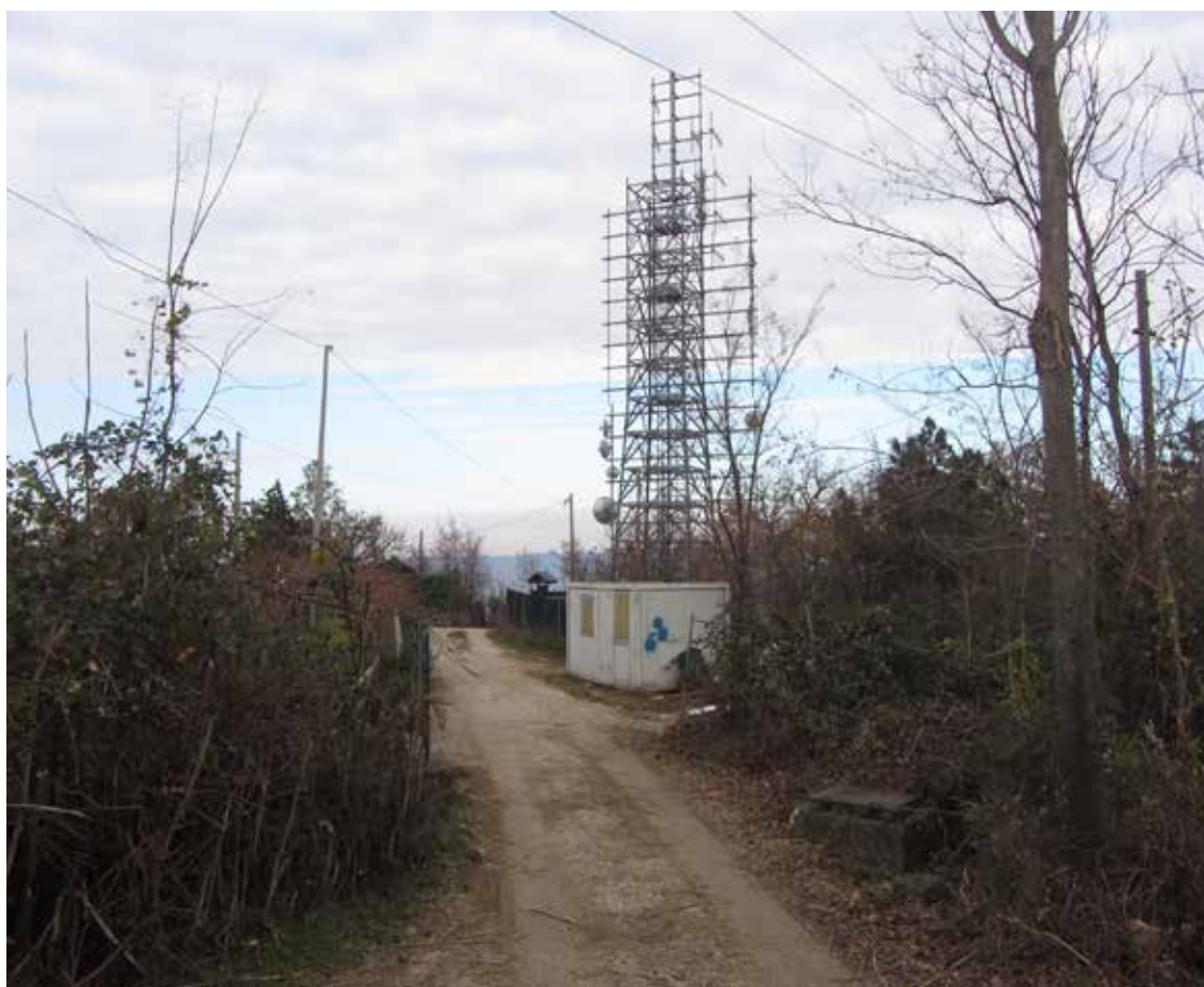
12. L'antenna per le telecomunicazioni impiantata in anni recenti su uno dei terrazzi sottostanti la sommità del Monte Castellier.
