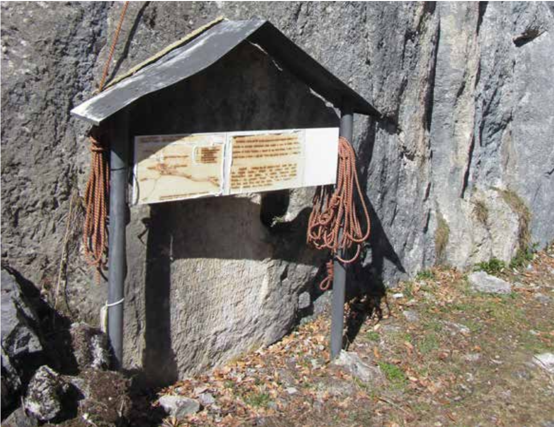
5. L'iscrizione come si presenta oggi: la copertura e il pannello illustrativo sono in evidente stato di degrado (sulla copertura sono appese delle corde di arrampicata).
