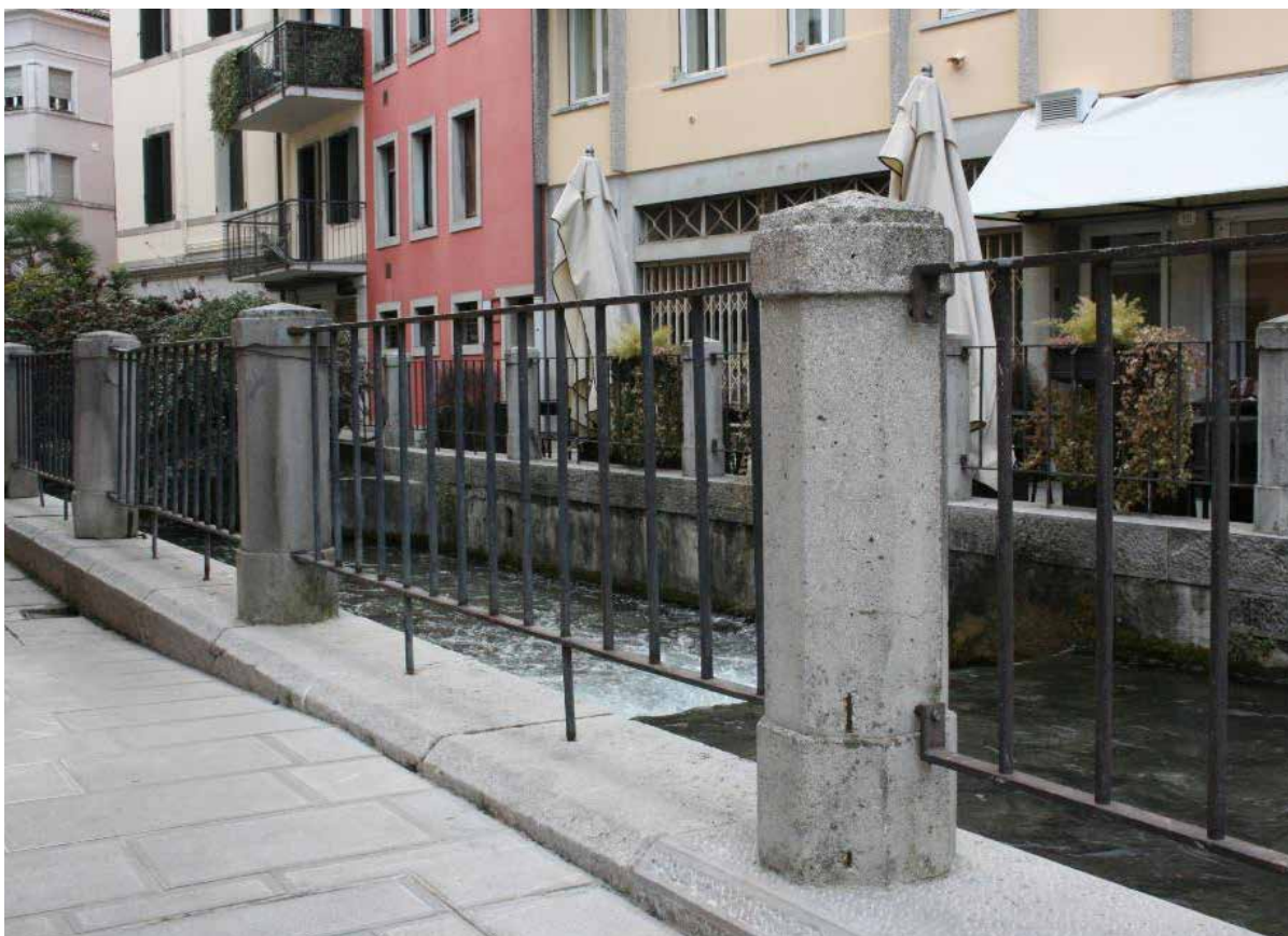
Parapetti e sponde in pietra sulla roggia di Udine in via Molin Nascosto – IMG_0269
