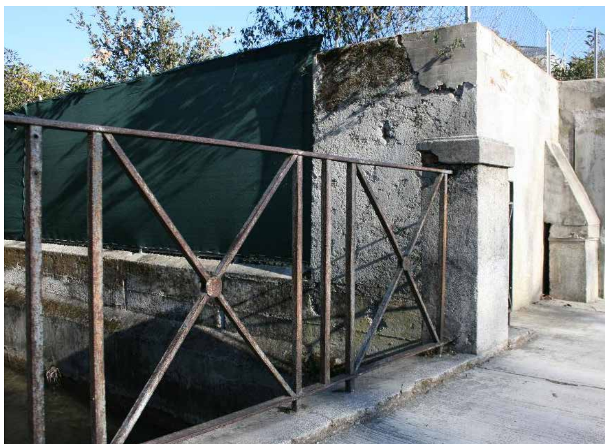
Caratteristico parapetto all'intersezione tra la roggia di Palma e via Melegnano - IMG_0289
