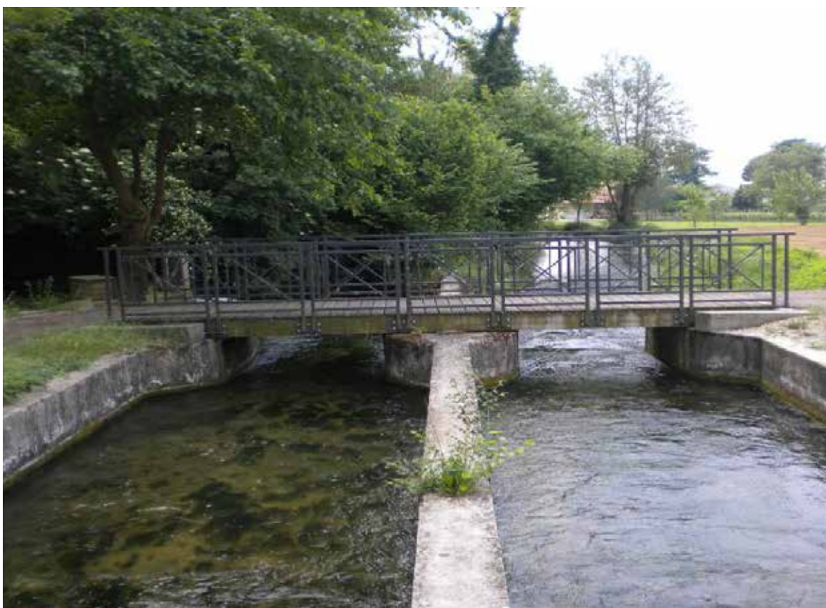
Divisione del canale Principale nelle Rogge di Udine e Palma con il nuovo ponte della pista ciclopedonale - DSCN0098
