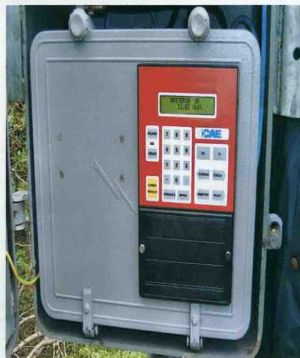
DETTAGLIO PANNELLO DI CONTROLLO
