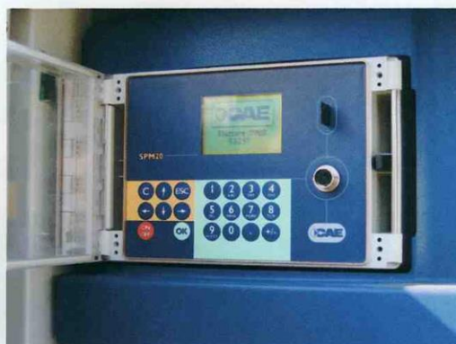
DETTAGLIO PANNELLO DI CONTROLLO
