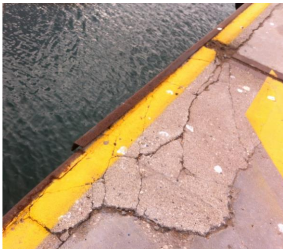
Figura 22 - Dettaglio relativo allo stato della pavimentazione della banchina; fonte: immagine di CoSEF.
