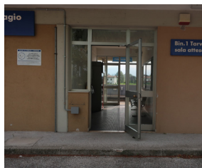
Mancata accessibilità strada-edificio stazione
