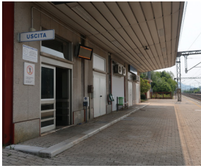
Assenza adeguata accessibilità edificio stazione-banchina 1
