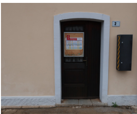
Mancata accessibilità strada-edificio
