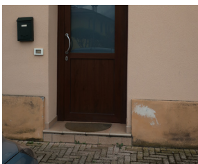
Mancata accessibilità strada-edificio stazione
