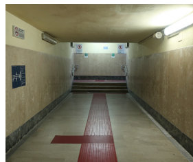
Assenza scivoli in sottopasso
