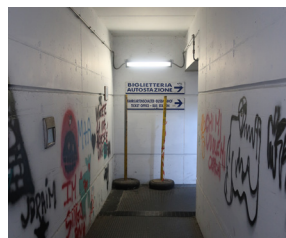
Presenza parziale di segnaletica direzionale per raggiungere interscambio
