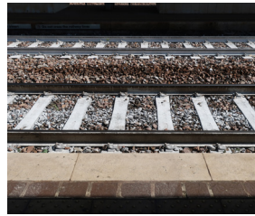
Mancato adeguamento banchine
