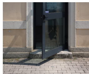
Assenza accessibilità strada-edificio stazione
