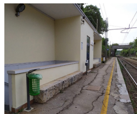
Mancanza adeguamento banchine
