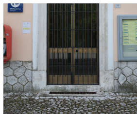
Assenza accessibilità strada-edificio stazione-banchina n.1
