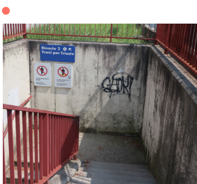
Mancata accessibilità al sottopassaggio
