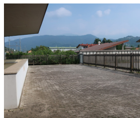
Mancata accessibilità strada-banchina 1
