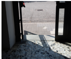
Mancata accessibilità edificio strada - stazione
