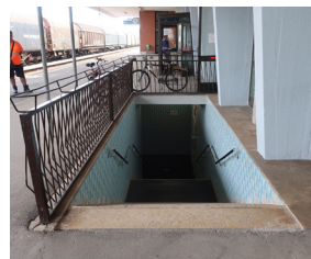
Mancanza sistemi che garantiscano l'accessibilità tra le banchine
