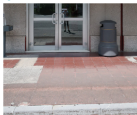
Mancata accessibilità strada-edificio stazione
