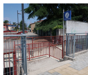
Mancata accessibilità al sottopassaggio
