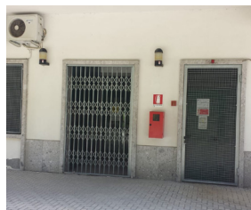
Mancanza accessibilità edificio
