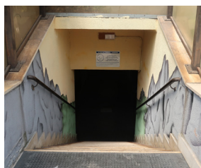
Assenza di rampe e scivoli in sottopasso
