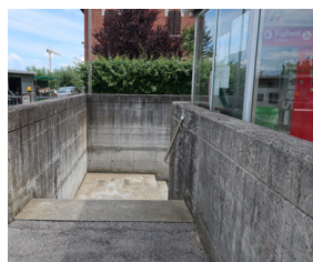
Presenza sottopassaggio non accessibile tra le banchine
