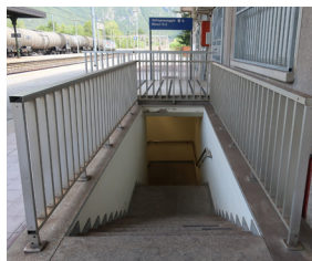
Assenza scivoli in sottopasso
