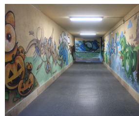
Assenza di rampe e scivoli in sottopasso
