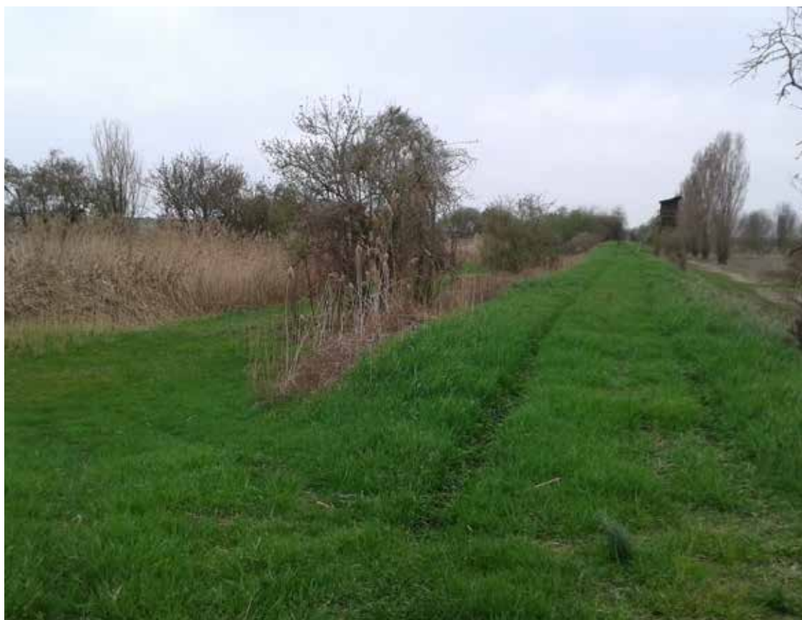
7. Il Canale Anfora in prossimità della laguna si presenta come un rilevato di terra.
