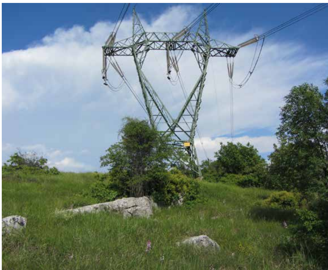
6. Il pilone dell'alta tensione impiantato sulla spianata sommitale.
