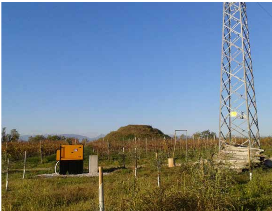
9. La centralina allestita in anni recenti nei pressi del palo della linea elettrica.
